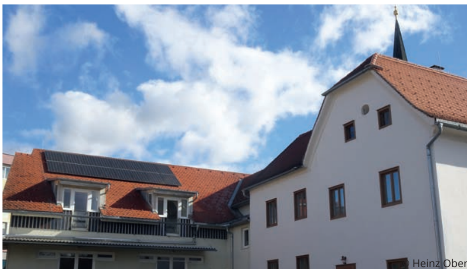
Photovoltaikanlage am Dach der Pfarre.
